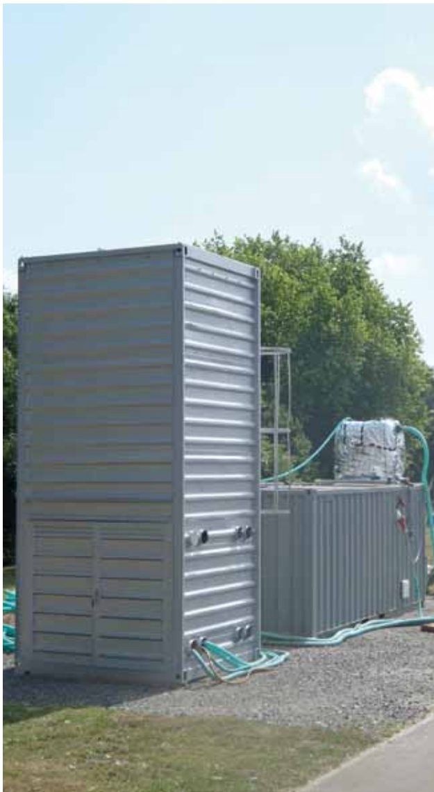
Abb. 2: MBR-Pilotanlage auf dem Klärwerk Osnabrück-Eversburg
