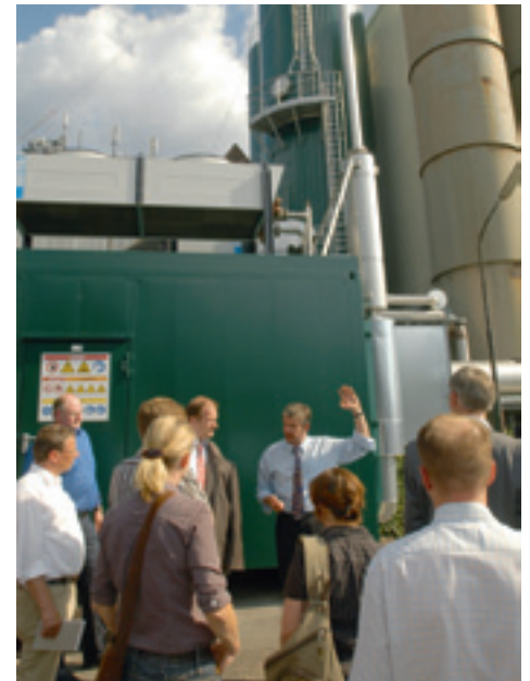
Betriebsbesichtigung mit dem technischen Leiter der Leiber GmbH in Bramsche, Dr. Ulrich Schmitz, vor dem Blockheizkraftwerk und den Türmen der neuen Biogasanlage.
